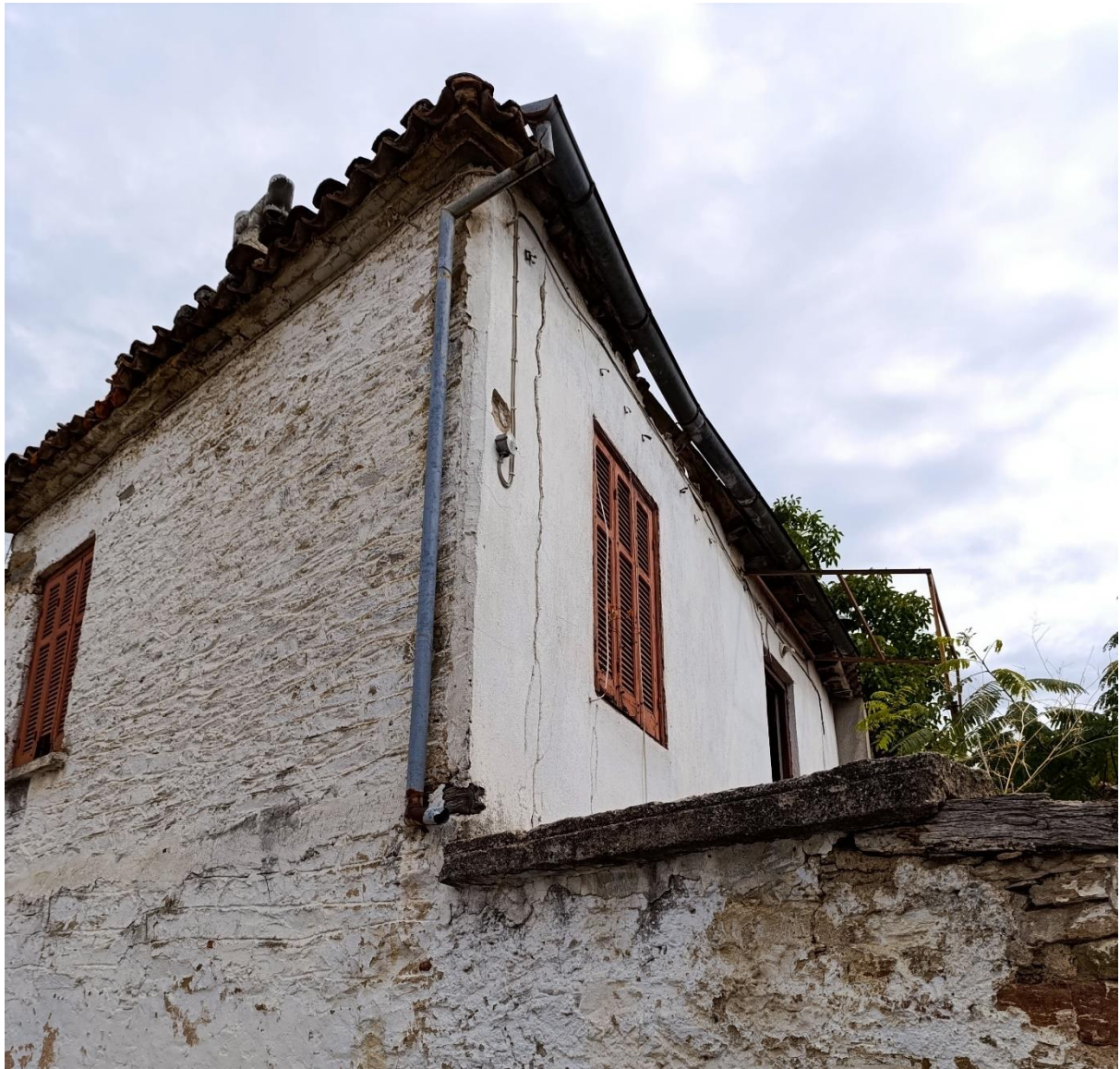
Φωτ.4 Λεπτομέρεια της κάθετης ρωγμής στον νότιο τοίχο του ορόφου
