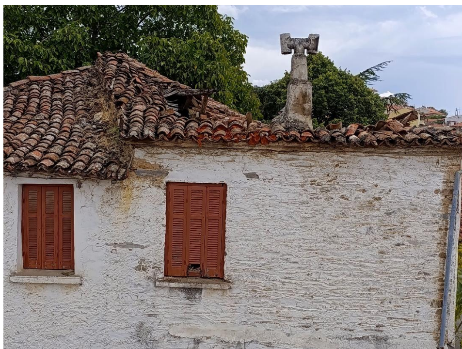
Φωτ.3 Λεπτομέρεια της δυτικής όψης όπου διακρίνεται η κατάρρευση της στέγης
