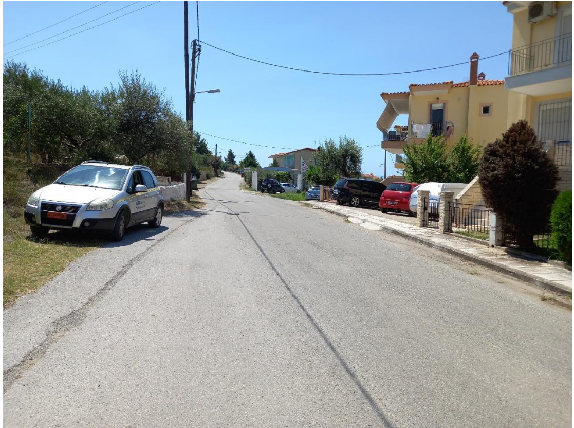
Ρηγματώσεις, λείανση επιφάνειας, απώλεια επιφανειακών υλικών ασφαλτοτάπητα.
