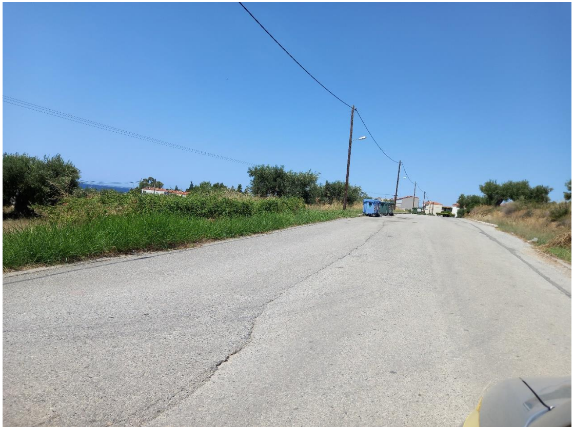
Ρηγματώσεις, λείανση επιφάνειας, απώλεια επιφανειακών υλικών ασφαλτοτάπητα.
