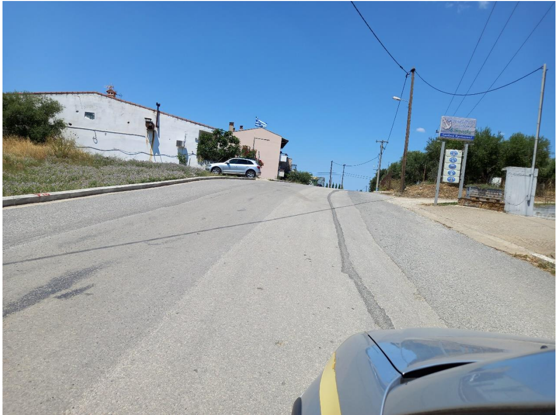
Ρηγματώσεις, λείανση επιφάνειας, απώλεια επιφανειακών υλικών ασφαλτοτάπητα.
