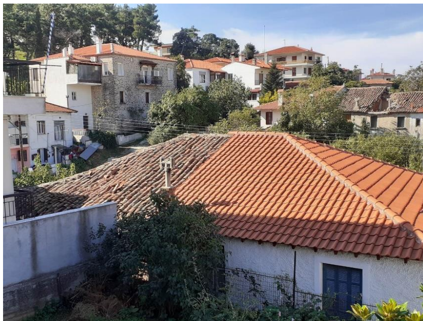
Φωτ. 8. Φωτογραφία των φθορών της στέγης (αριστερό τμήμα)
