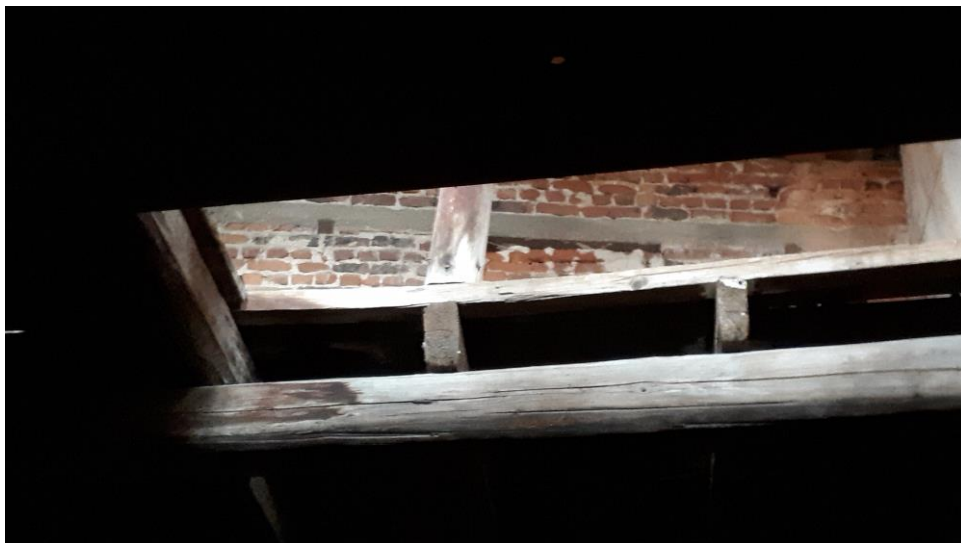
Φωτ. 7 Η βάση του υποστυλώματος της στέγης του προσκτίσματος.
